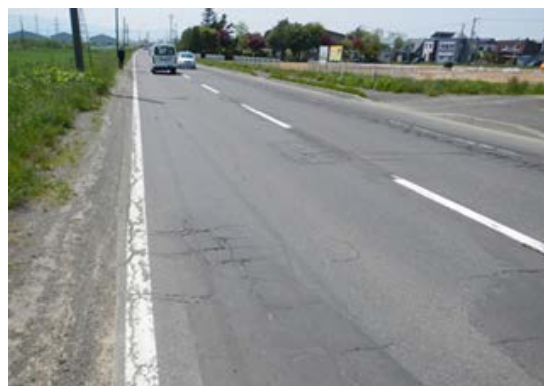
〔施工前の路面状況〕
