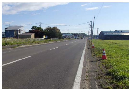
〔供用420日後、薄層シングルメルトの路面状況〕
