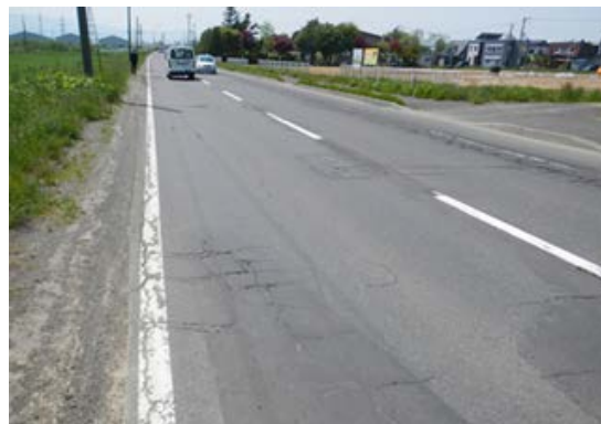
〔施工前の路面状況〕
