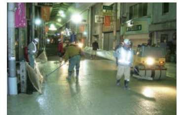
早期交通開放が必要な箇所
