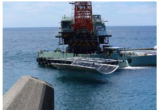
洗掘防止用アスファルトマット敷設工事 (北陸地方整備局 敦賀港湾事務所) 【福井県福井市】
