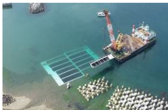
洗掘防止用アスファルトマット敷設状況 (大分市 上浦漁港 離岸堤の洗掘・吸出し防止)
