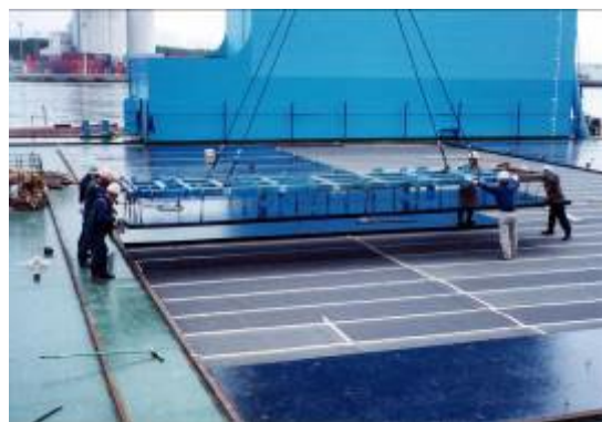
摩擦増大用アスファルトマット敷設状況 (宮崎県 宮崎市 フローティングドック上)
