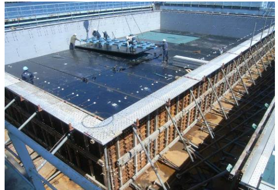
摩擦増大用アスファルトマット敷設工事 (青森県 下北地域県民局) 【青森県むつ市】
